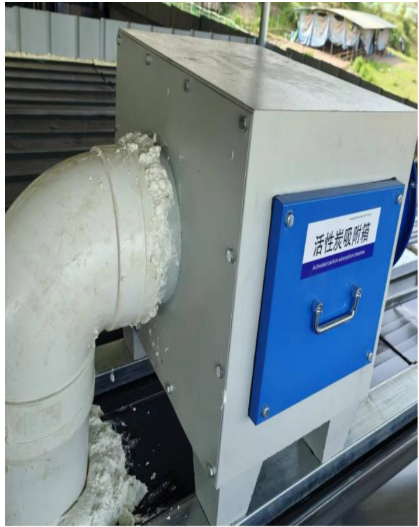
危废贮存废气处置措施
