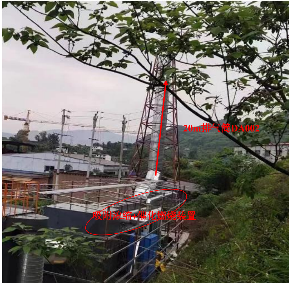
喷涂废气“吸附浓缩+催化燃烧”装置及排气筒室外
