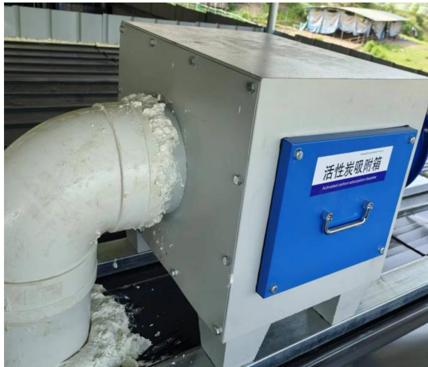
危废暂存间废气“活性炭”处理装置
