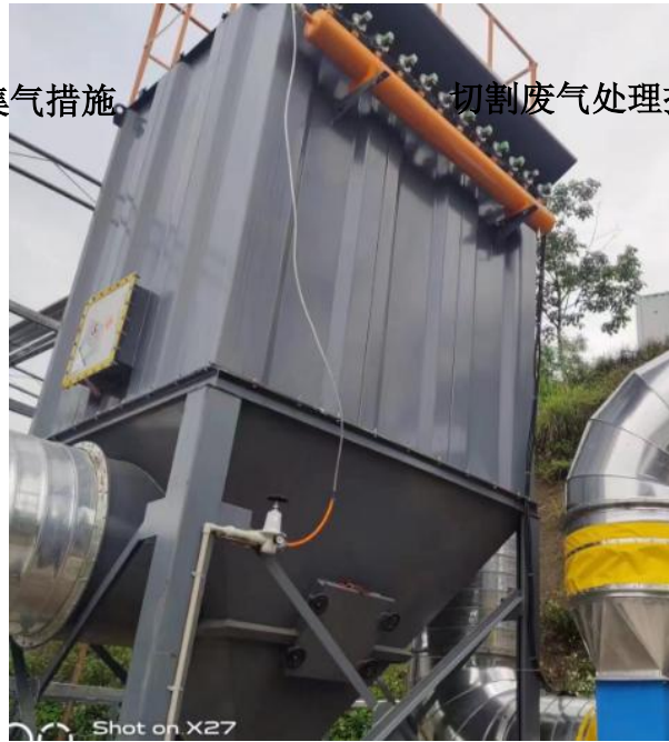
切割废气布袋除尘器
