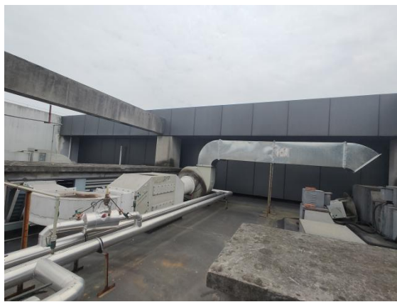
图 3.1-5 活性炭吸附箱和 2#排气筒
