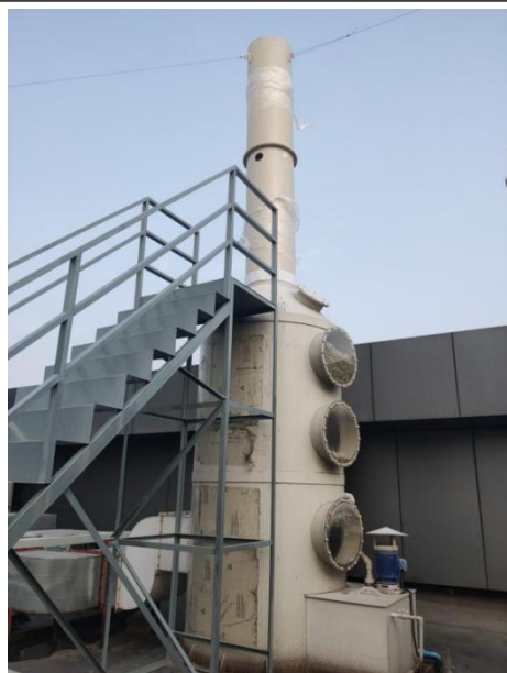
图 3.1-7 动物房喷淋塔及 4#排气筒
