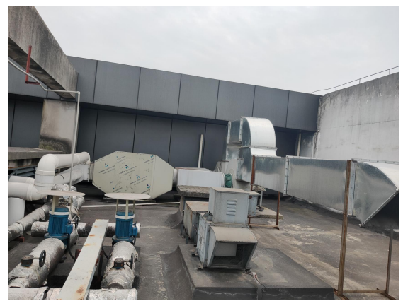
图 3.1-6 活性炭吸附箱和 3#排气筒
