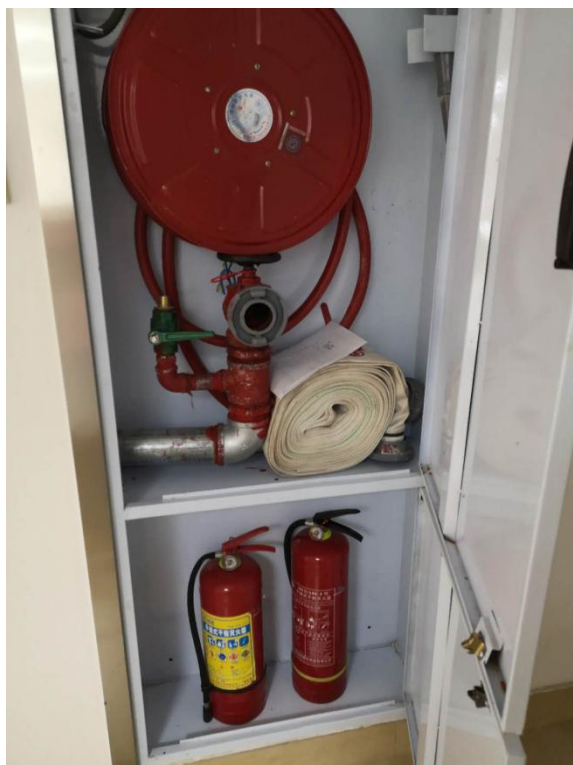
图 3.5-1 消防栓、灭火器
