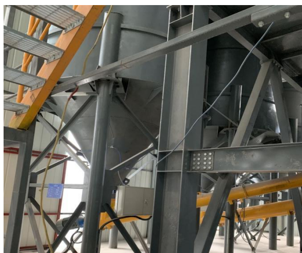
水泥/粉煤灰料仓
