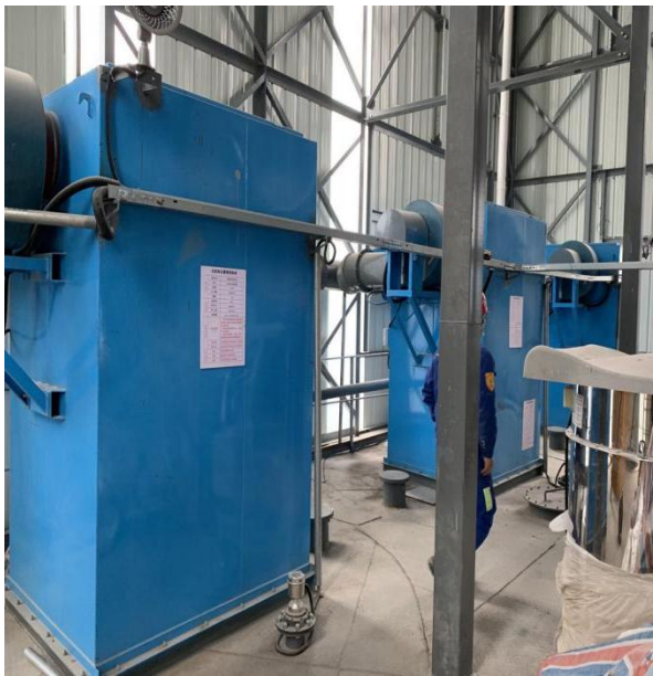
水泥、石灰石筒仓除尘器
