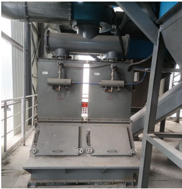
外加剂筒仓除尘器
