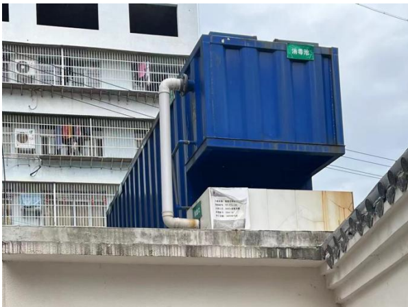
一体化污水处理设施
