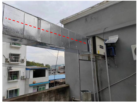
油烟排放管道
