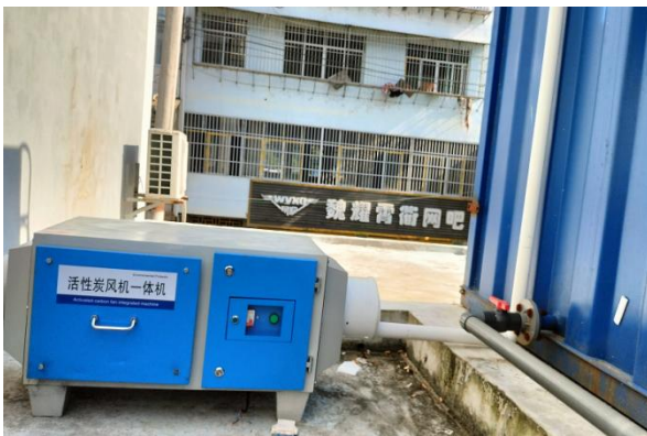
活性炭吸附装置（污水处理设施臭气）
