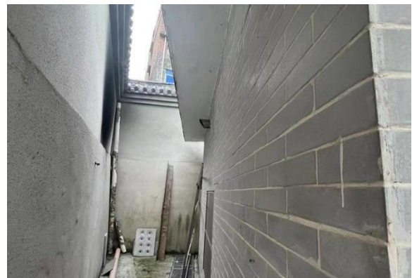
柴发废气排放口
