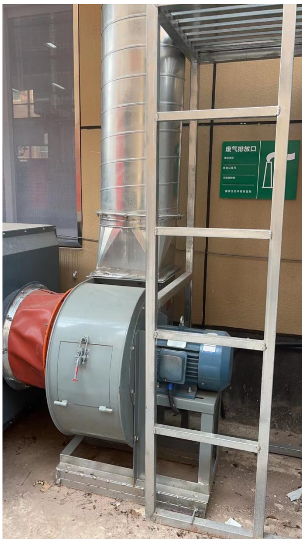
废气排放口检测平台及排放标识
