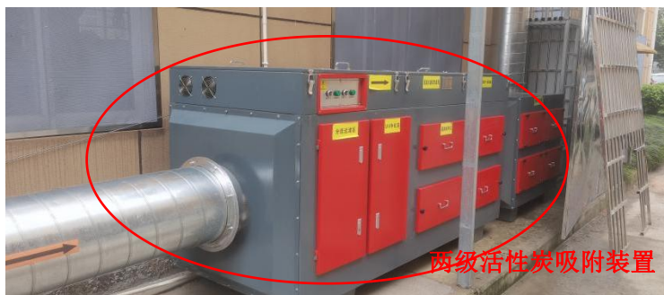
注塑废气治理设施
