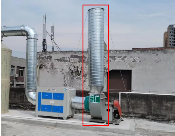
图 3.1-3 废气排气筒及标识
