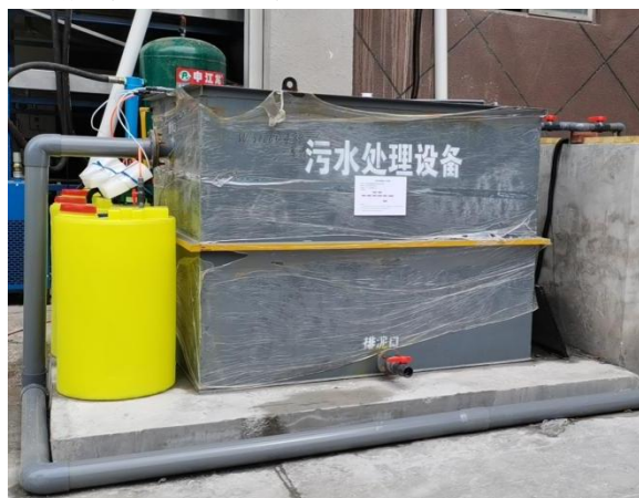
图 3.2-2 一体化污水处理设施
