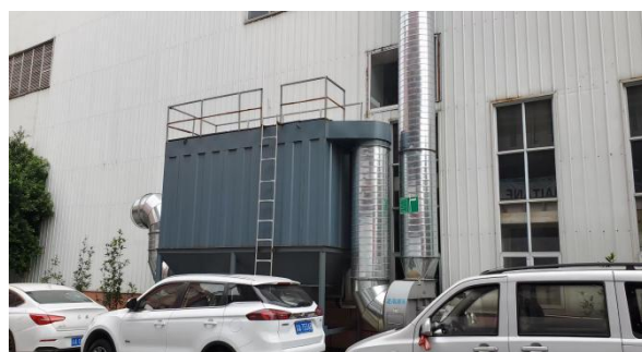
焊接烟尘治理设施及排放口标识牌
