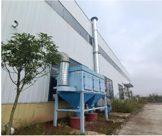
布袋除尘器及排气筒
