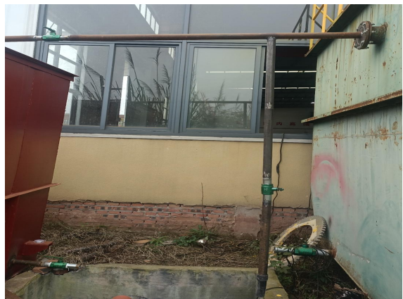
事故池切换阀
