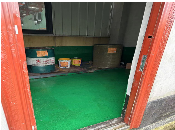
危废间围堰、托盘及防渗措施
