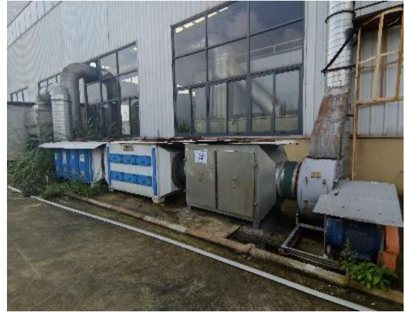
喷漆废气处理设施
